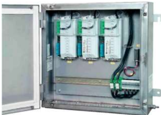
Рисунок 22 - Системное решение – три полевых барьера в шкафу из нержавеющей стали
