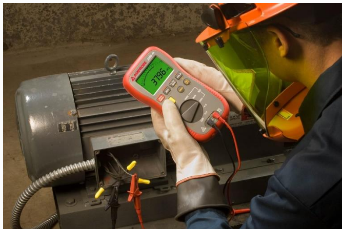
Рис. 1. Замер сопротивления изоляции электродвигателя мегаомметром
