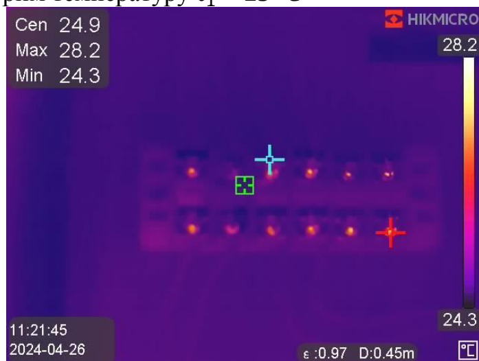
Рис. 7. Термограмма плохого контакта до начала работы
